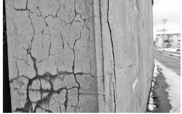
反応性骨材と高いアルカリ性と降雨などの水分が揃って、膨張性のひび割れを発生させた（アルカリ骨材反応・RC擁壁）。
