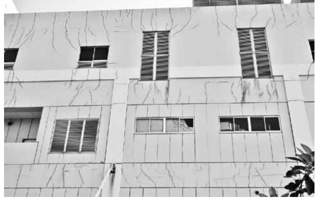
RC建物のひび割れは半ば宿命的。幅0.4mm以上のひび割れは内部鉄筋の腐食を誘発する(延命策を講じた補修の痕跡)。
