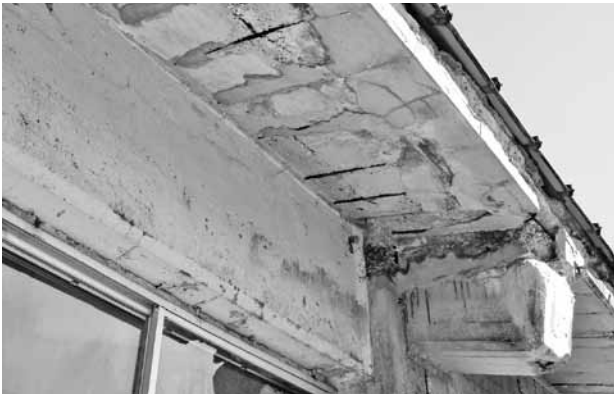
二酸化炭素によってコンクリートは中性化し、水分の下で内部鉄筋が腐食し膨張。その結果、コンクリートを剥離させた。
