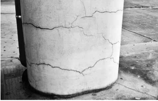
反応性骨材と高いアルカリ性と降雨などの水分が揃って、膨張性のひび割れを発生させた（アルカリ骨材反応・RC柱）。
