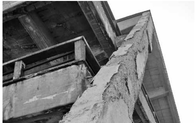
コンクリート中の水分が凍結と融解を繰り返し、ひび割れを発生させた後、表層コンクリートを剥離・剥落させた(凍害)。
