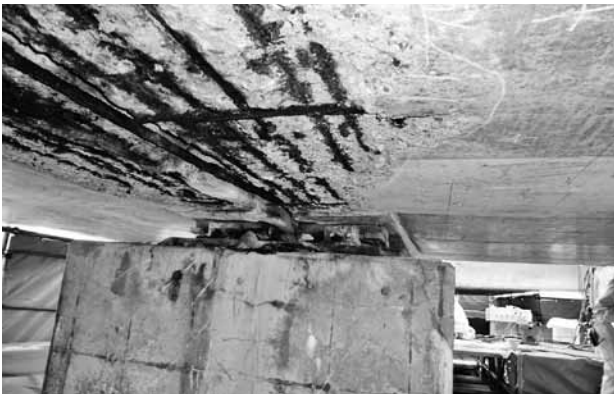
塩分がコンクリート中に入り込み、内部の鉄筋が腐食し、体積膨張によりコンクリートを剥落させた(塩害・築後30年)。
